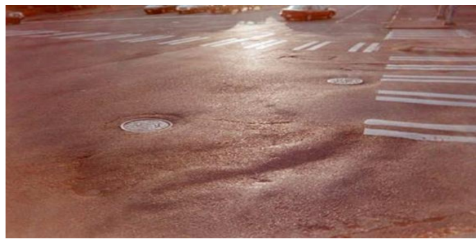
Fig. 8. Wave in asphalt.
